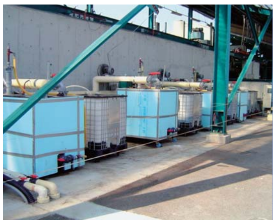
▼実証プラントに設置した試作スクラバ
