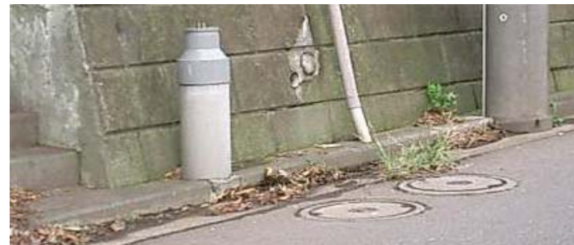
公共下水道の利用
