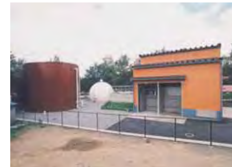
バイオガスプラント
